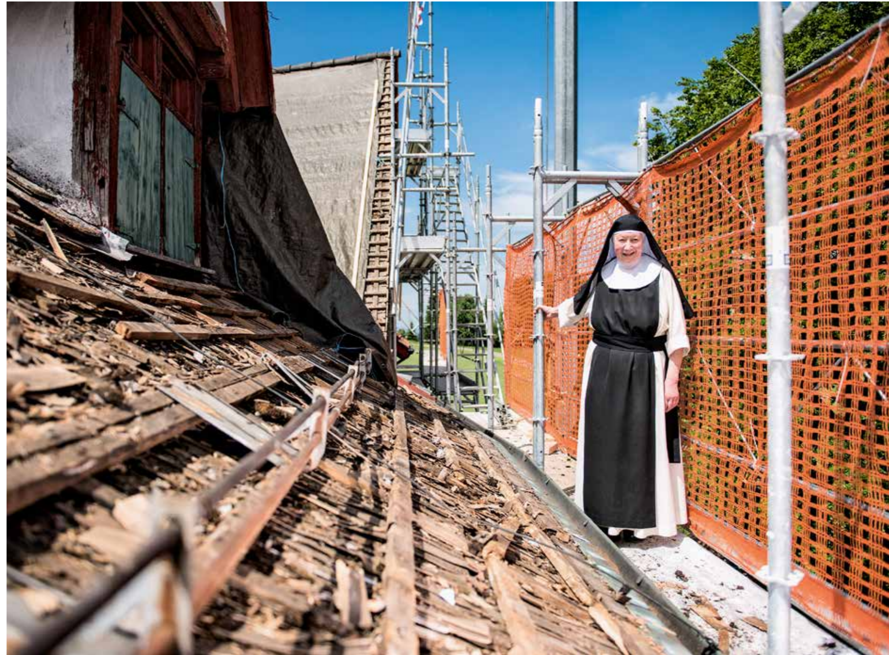
Die Äbtissin, Schwester Maria Raphaela, freut sich auf den Tag, wenn die Finanzierung des neuen Klosterdachs geregelt und der Baulärm überstanden ist.
