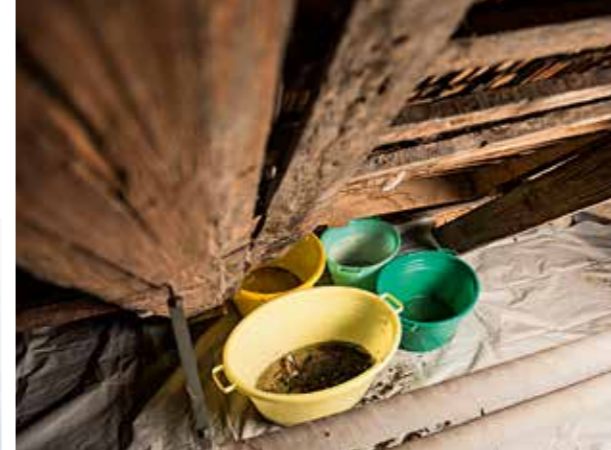
Die Dachsanierung ist dringend nötig: mit Becken muss eindringendes Regenwasser aufgefangen werden.
